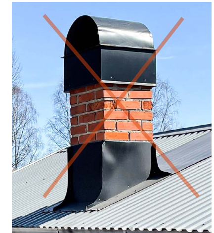
Huv är överdimensionerad och överbeslaget går ned över skorstensmuren. Upplevelsen av beslagen blir mer dominerande än av själva skorstenen.
