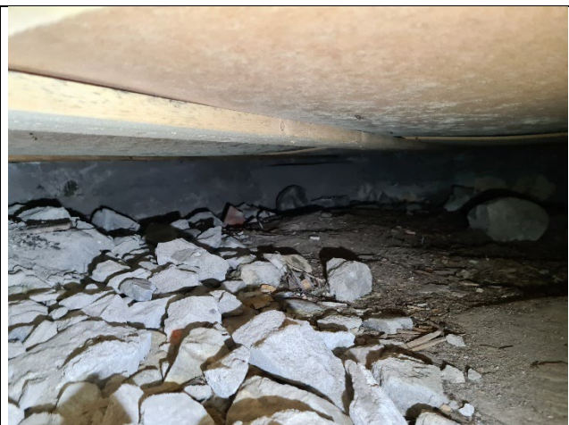
Bild 10: Riskkonstruktion i kryppgrund
