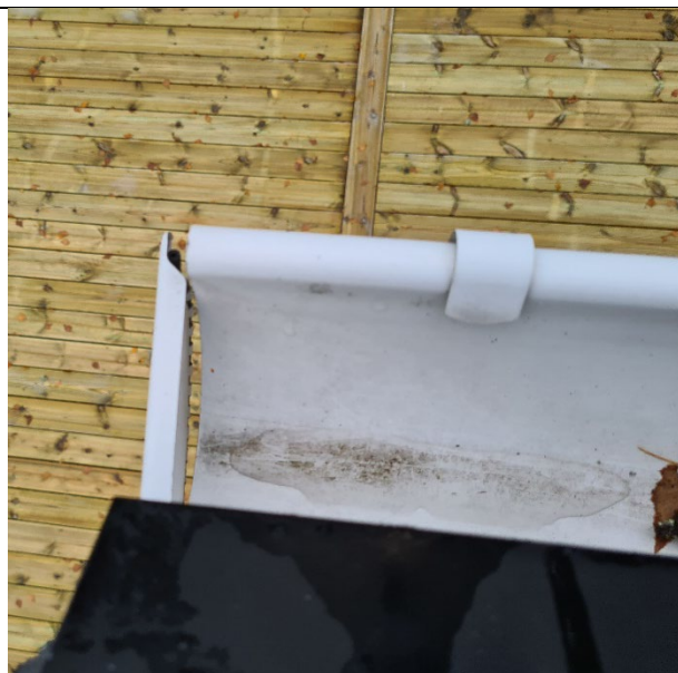
Bild 18: Takavvatning behöver översyn/service.
