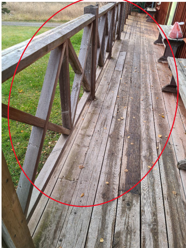
Bild 13. Altan och träräcke, slitage/skador
