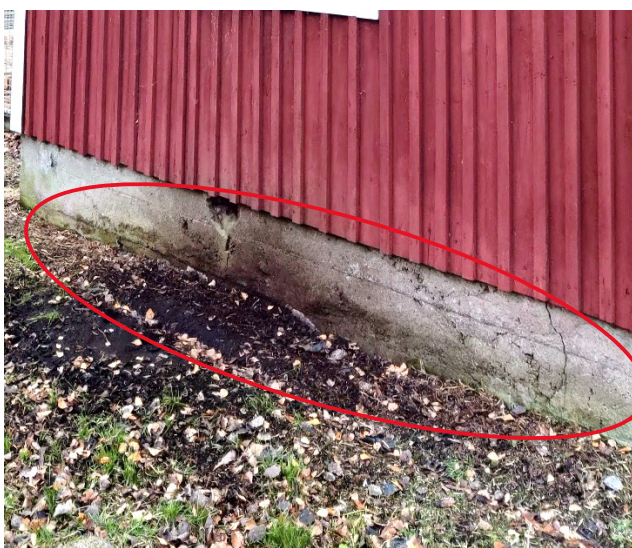
Bild 1. Fasad och Grund/Sockel, sprickor och skador. Fuktfläckar bedömt härrörande från verksamhet.
