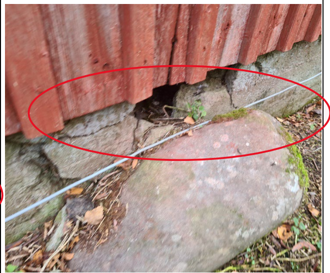
Bild 2: Lokala skador på sockel
