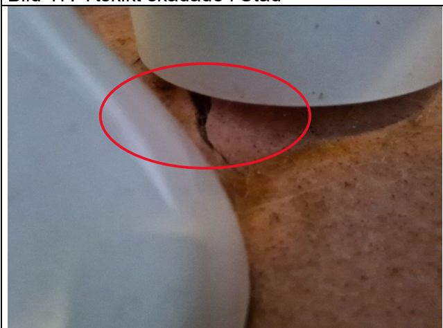
Bild 18: Sprickor i matta i Wc
