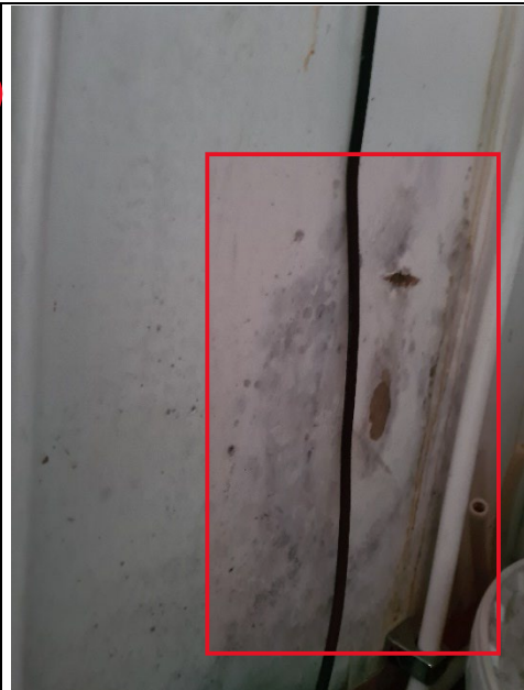
Bild 16: Ytskikt fuktpåverkade i Städ
