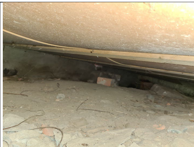
Bild 11: Riskkonstruktion i kryppgrund
