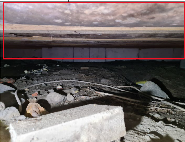
Bild 17. Krypgrund, fuktanvisningar i trossbotten
