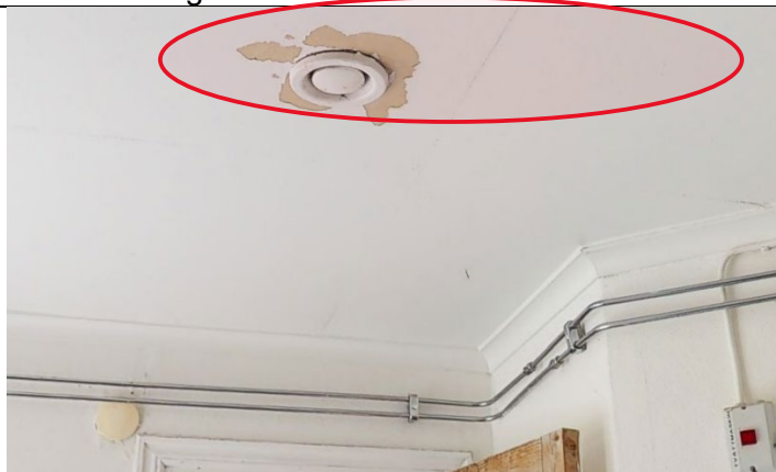
Bild 14: Slitage i omklädningsrum
