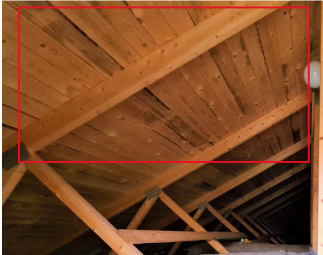
Bild 11 kallvind, begynnande läckage noteras i underspiknig
