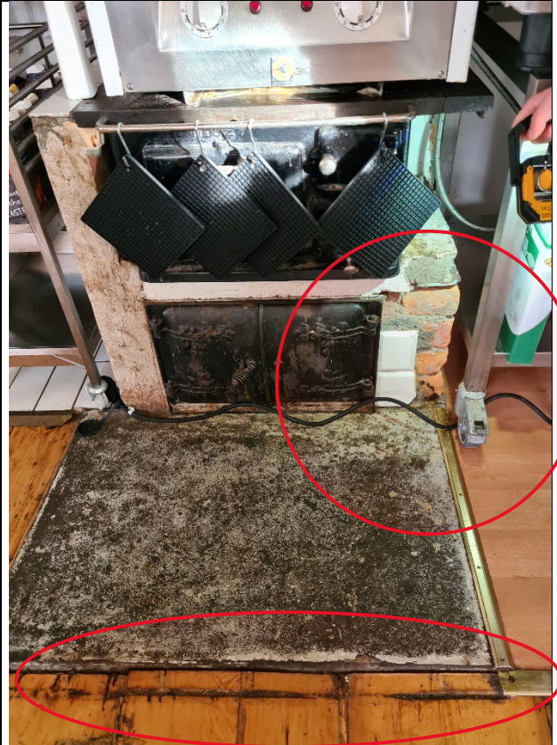
Bild 26: Matsal/Kök fd. vedspis ej i drift gnistskydd av typ cement. Skadade ytskikt.
