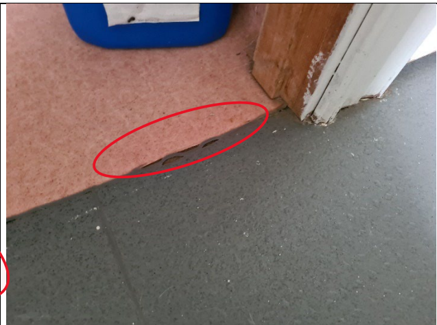
Bild 17: Sprickor i mattskarv i Wc
