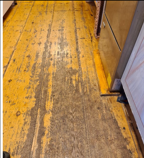
Bild 22: Golv i Matsal/Kök, högt slitage, fuktpåverkan pga diskbänk. Ej lämpligt golv i tillagningskök.
