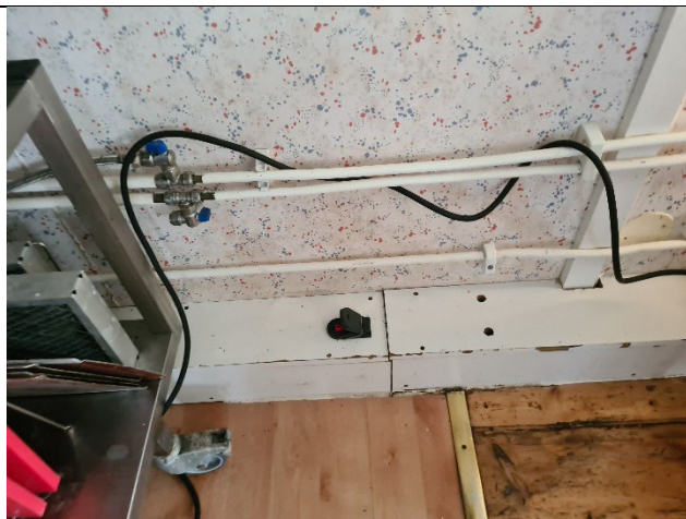
Bild 23: Matsal/Kök, nisch i ej fukttåligt material. Skadade ytskikt.
