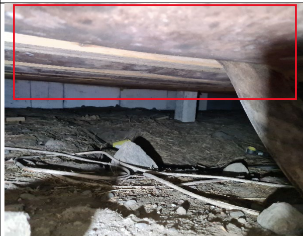
Bild 18. Krypgrund, fuktanvisningar i trossbotten
