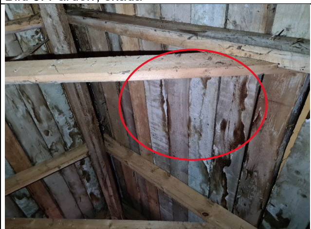
Bild 7: Rote, äldre fuktanvningar
