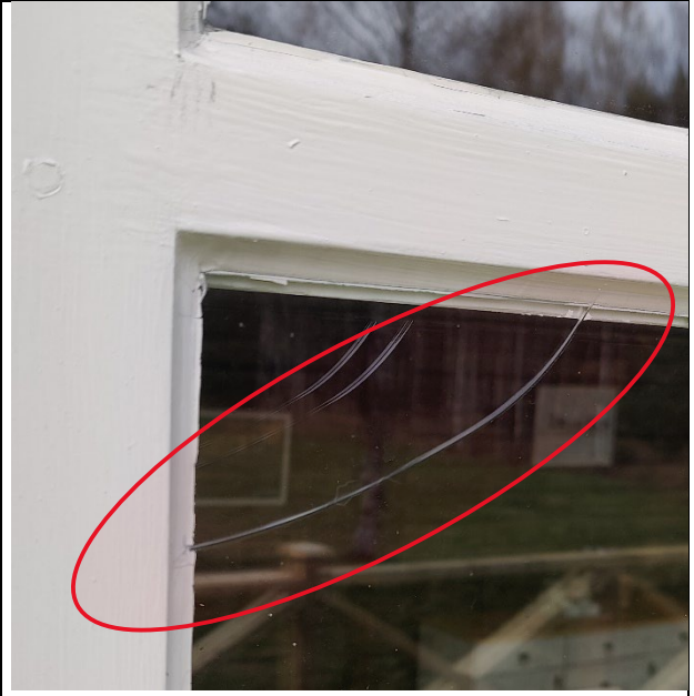
Bild 31: Veranda, sprickor i ytterglas
