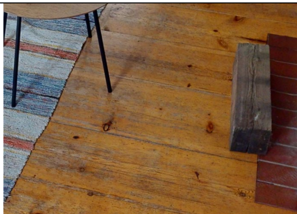
Bild 20: Golv i storstuga högt slitage
