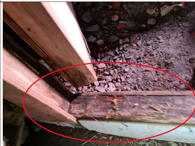
Bild 19. Dörr till krypgrund, skada
