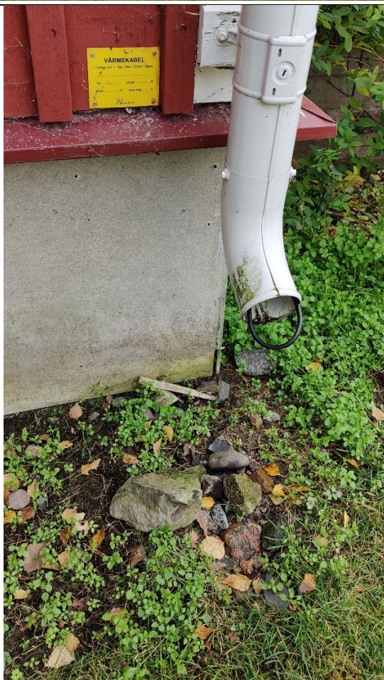
Bild 1: Markskada samt lutning mot grund
