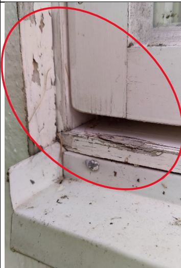
Bild 9: Fönster, exempel på slitage.
