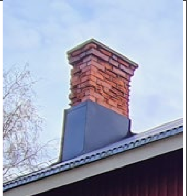
Bild skorsten noteras ha kraftiga skador i murning
