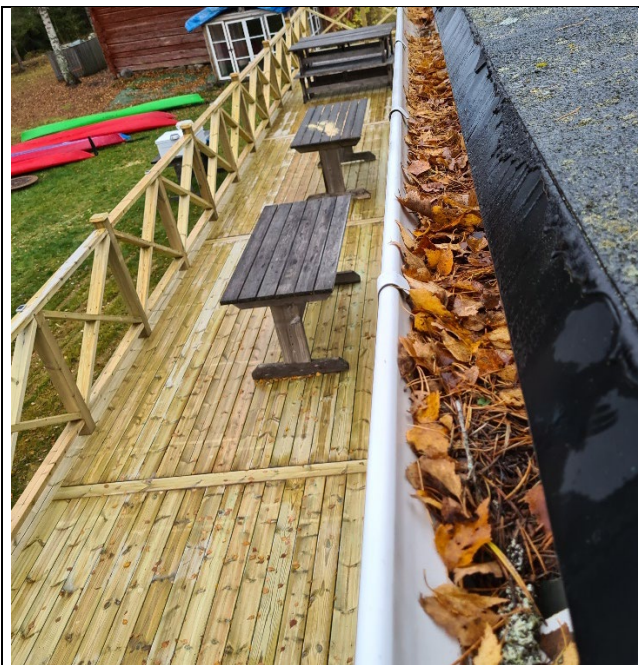
Bild 17: Takavvatning behöver översyn/service.
