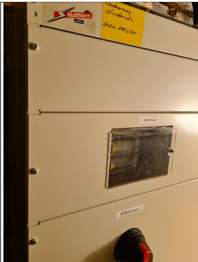
Bild 38: Ventilationsaggregat, nyare el, ventilation
